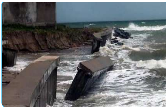
Hình 6.8. Sạt lở bờ kè biển tại thành phố Hội An
