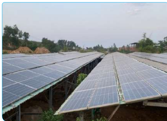
Hình 6.13. Hệ thống điện mặt trời tại Quảng Nam
