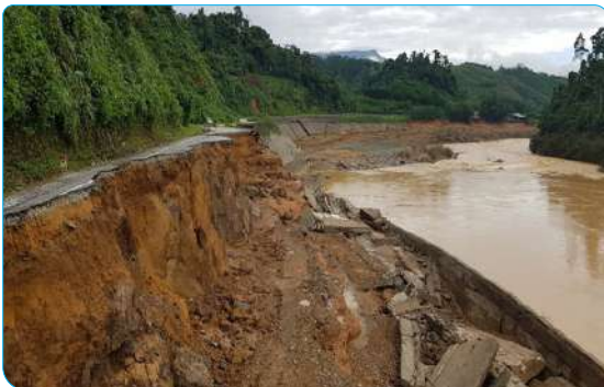
Hình 6.1. Sạt lở đất tại huyện Phước Sơn
